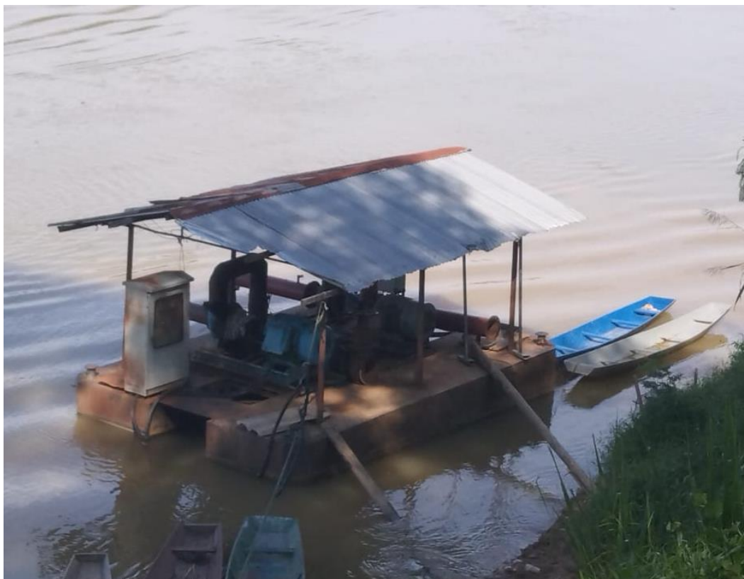
ຮູບພາບ 5. ສະພາບຫົວງານໃນປະຈຸບັນ ແລະ ສະເໜີປັບປຸງ (ໂຄງການປ່ຳນ້ຳຊົນລະປະທານລາດຄວາຍ)
